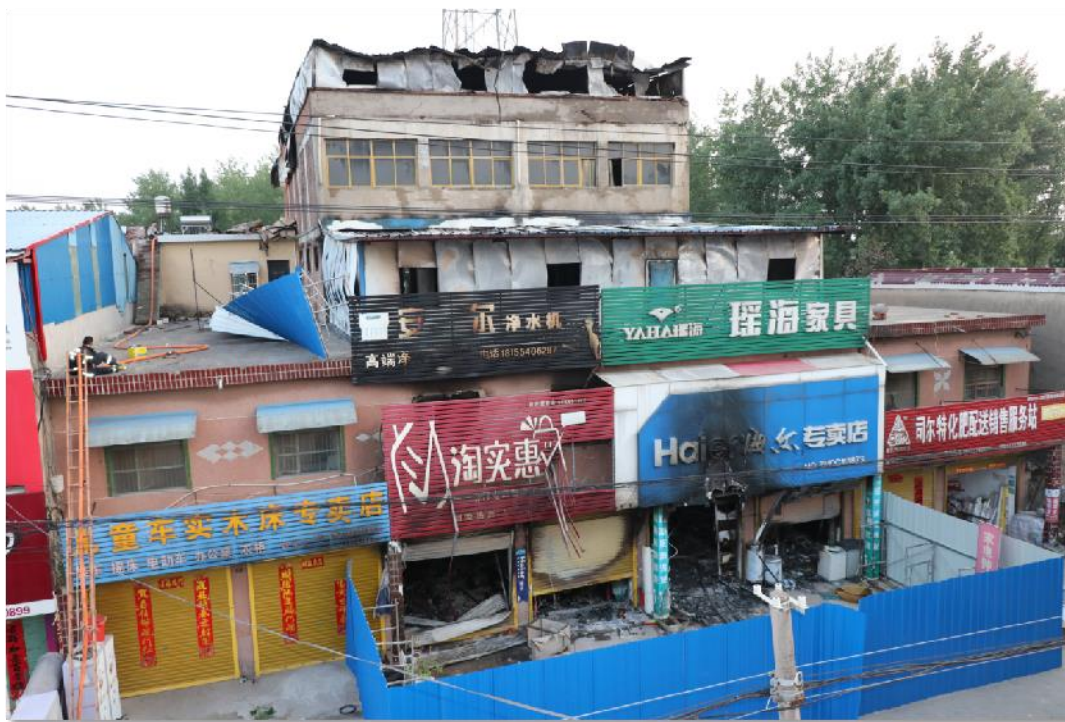
图 9 事故建筑过火后外观图
