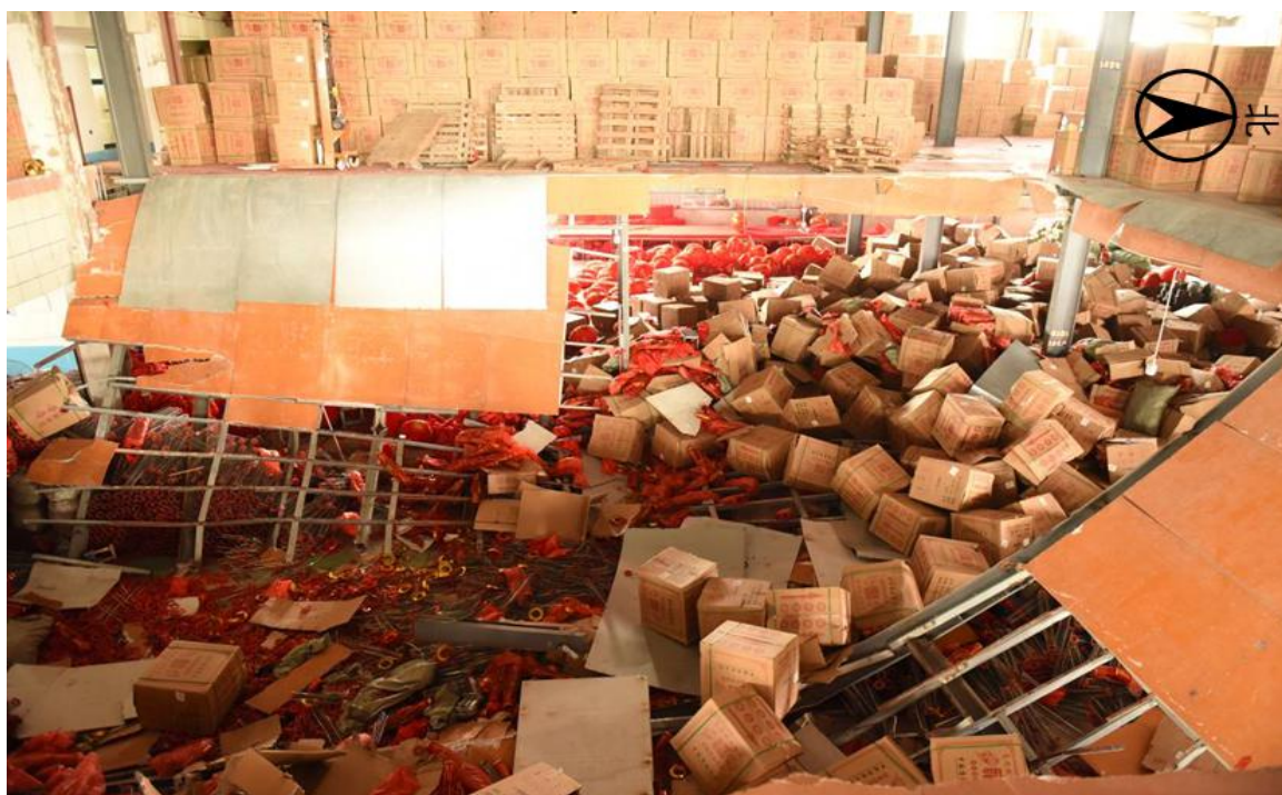
图10 二层坍塌区域（由东向西拍摄）
