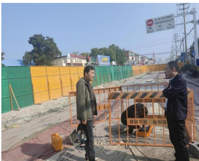
图5 事发污水井周边情况（二）
