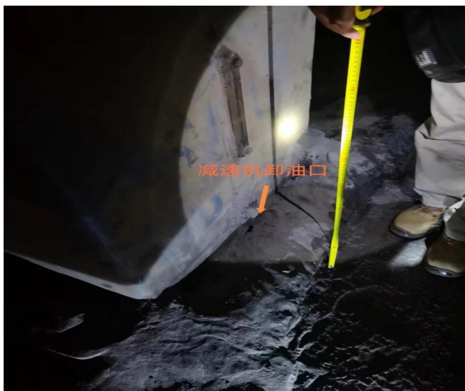
图 3 东侧减速机卸油口
